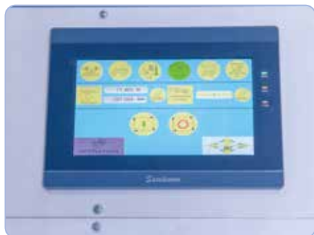
Toate setările au loc prin intermediul unui sistem de comandă PLC sinoptic.
