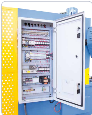
Hochwertige Elektrokomponenten von z.B. Schneider Electrics
